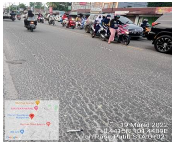
Gambar 1. Situasi Jalan Pasir Putih
