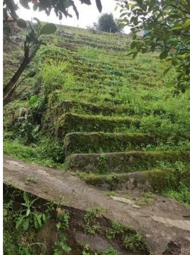
Gambar 3 Bronjong sebagai perkuatan lereng jalan Cisasawi
