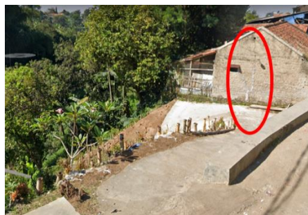
Gambar 2 Keretakan rumah di pinggir jalan Cisasawi akibat pergerakan tanah
