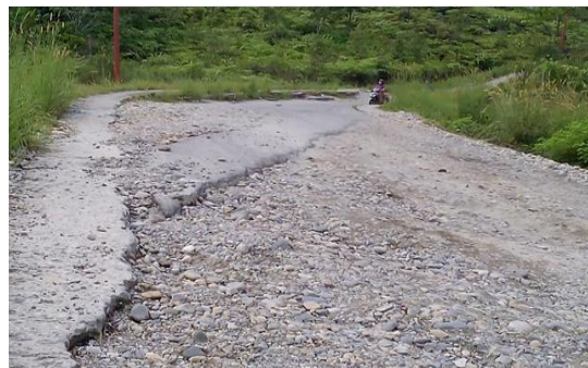
Gambar 1 Penurunan ( Settlement ) pada ruas jalan Subulussalam – Lipat Kajang Km 605+400
