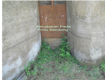
Gambar 3 Kerusakan Pada Pintu Bendung
