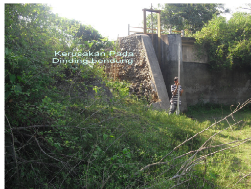
Gambar 2 Lokasi Kerusakan Dinding Bendung
