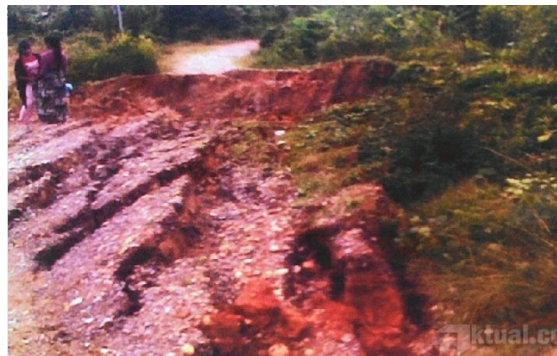
Gambar 1 Tipe kelongsoran tepat pada badan jalan
