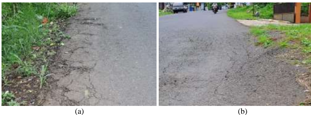
Gambar 6 Jenis kerusakan perkerasan lentur (a) Retak Tepi (b) Sungkur ( shoving )
