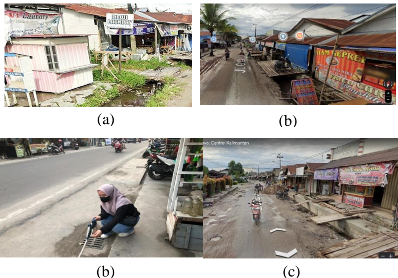
Gambar 2 (a) foto tahun 2020, salah satu lokasi saluran drainase yang rentan banjir sebelum normalisasi, (b) foto tahun 2022, kegiatan normalisasi, (c) foto tahun 2023, kondisi sesudah normalisasi
