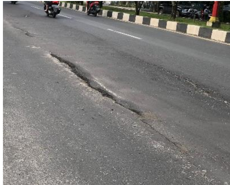
Gambar 11 Kerusakan jalan di Kota Palangkaraya, Kalimantan Tengah
