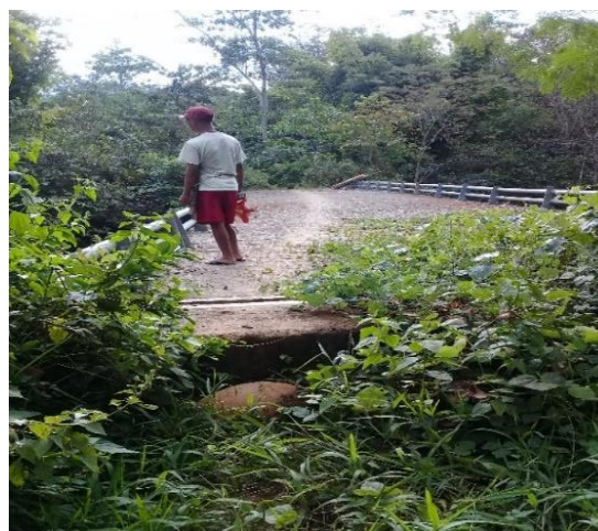
Gambar 2. Kondisi jalan sebelum jembatan
