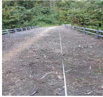
Gambar 3 Kondisi lantai kendaraan dan tiang sandaran
